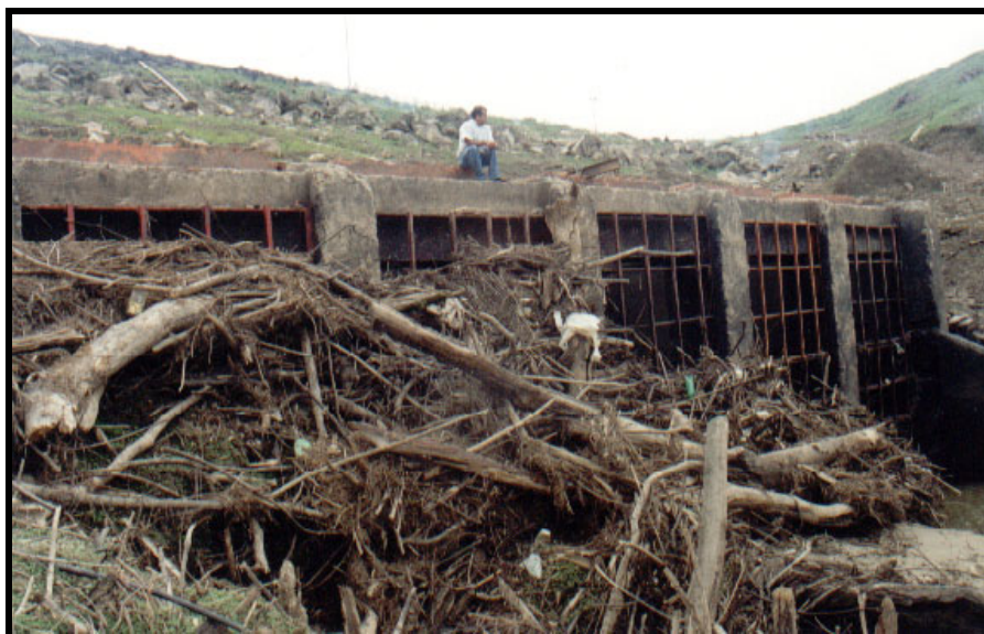
FIGURA 1.12 – EXEMPLO DE OBSTRUÇÃO DOS DESCARREGADORES DE FUNDO DA BARRAGEM SUL, EM ITUPORANGA, COM ENTULHO PROVENIENTE DO ESCOAMENTO DO RIO ITAJAÍ DO SUL
