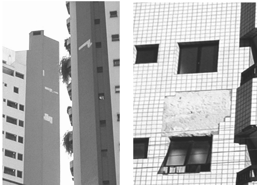
Figura 4.1: Edifícios com destacamento de placas cerâmicas em fachadas
