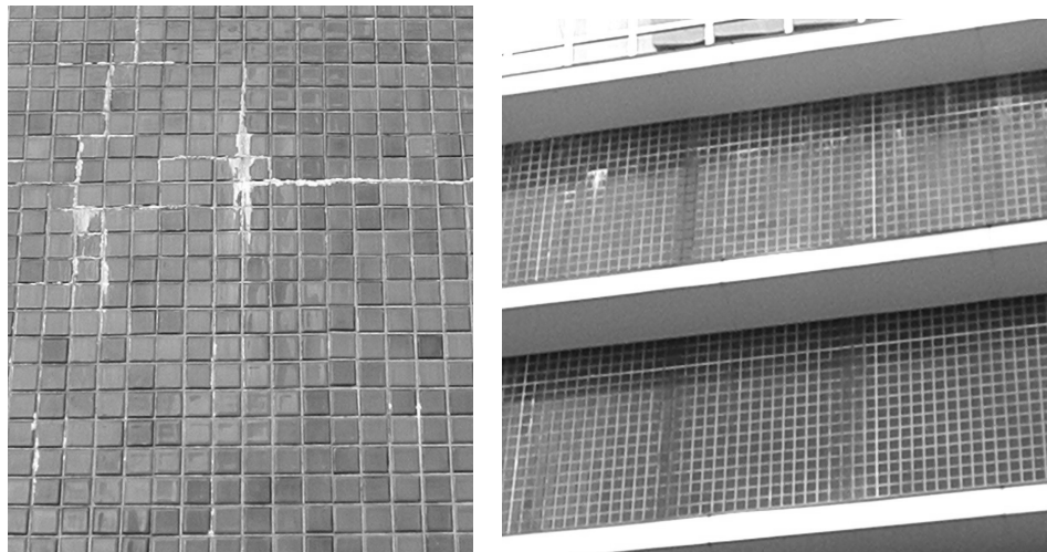
Figura 4.4: Eflorescências em fachadas de edifícios com placas cerâmicas
