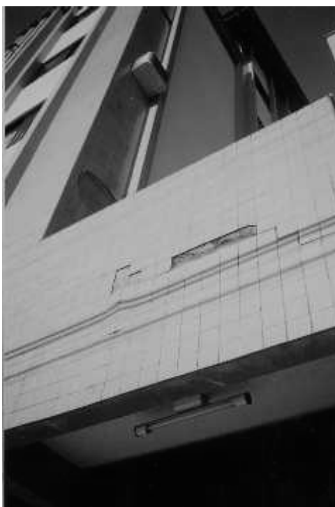
Figura 5.27: Destacamento de placas cerâmicas
