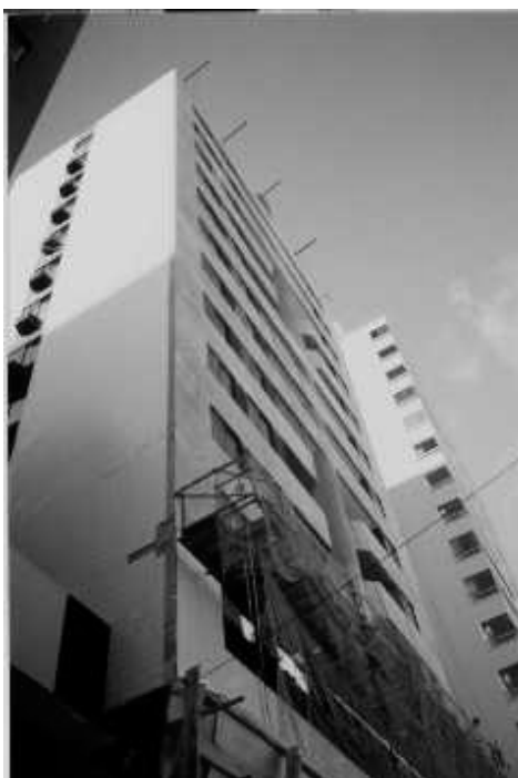
Figura 5.19: Ausência de juntas de movimentação
