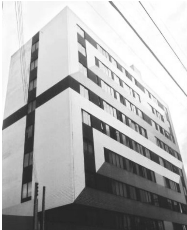
Figura 5.10: Ausência de juntas de movimentação
