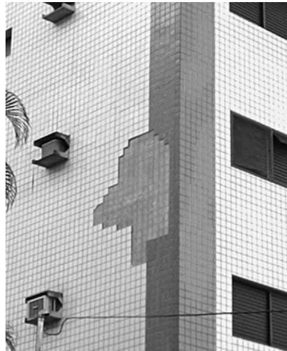
Figura 4.2: Destacamento de placas cerâmicas
