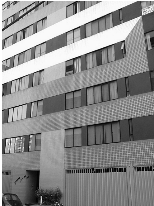
Figura 5.12: Manchas nos rejuntas
