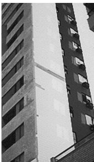
Figura 5.20: Destacamento de placas cerâmicas
