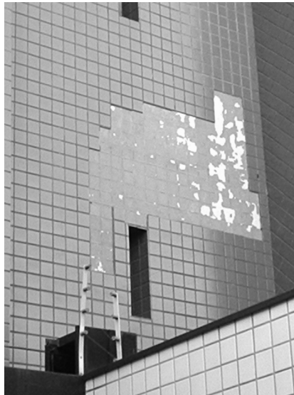
Figura 4.3: Destacamento de placas cerâmicas nos primeiros pavimentos
