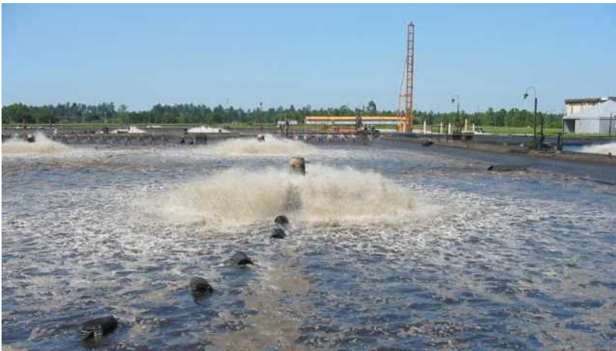
Figura 18 – Aeração mecânica da lagoa de estabilização aerada.
