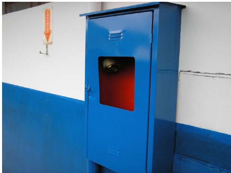
FIGURA 38: Caixa de mangueira de hidrante – cor fora de norma
