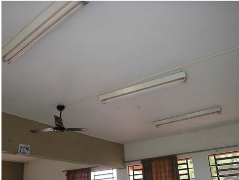
FIGURA 13: Iluminação e ventilação artificial
