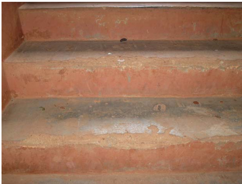
FIGURA 8: Detalhe do bocel do degrau quebrado
