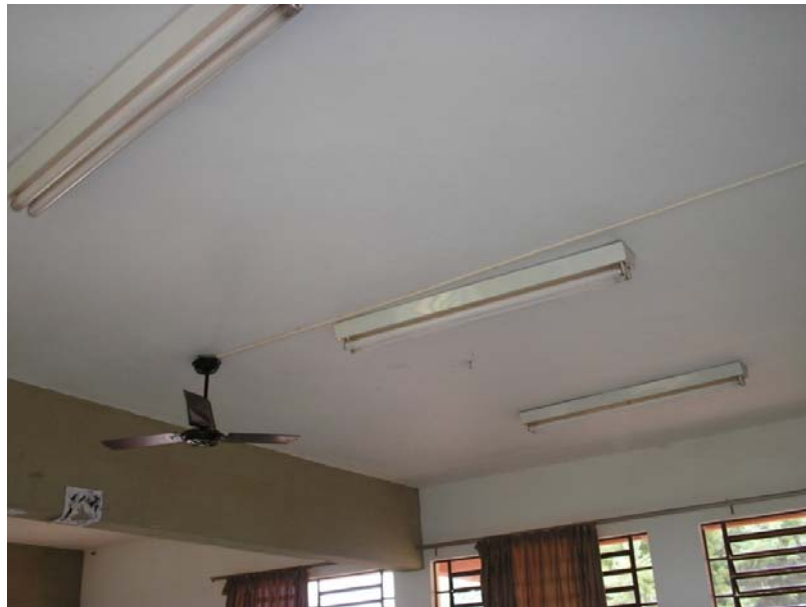
FIGURA 36: Iluminação e ventilação artificial
