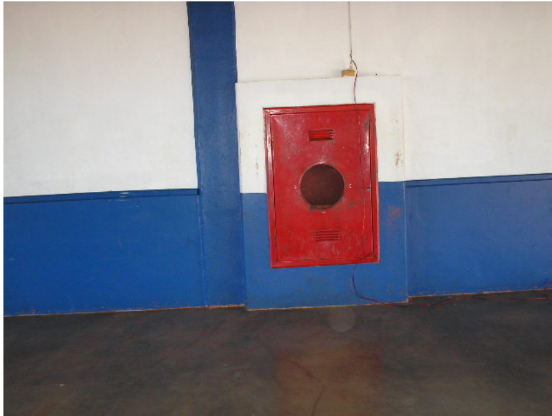
FIGURA 24: Hidrante sem mangueira e sem vidro.
