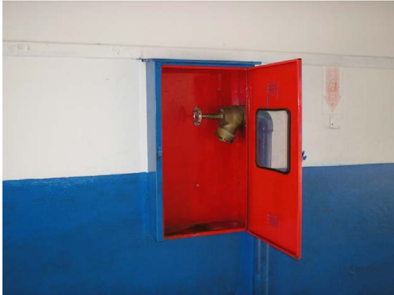
FIGURA 37: Caixa de mangueira de hidrante
