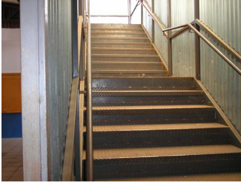
FIGURA 32: Detalhe da escada improvisada.
