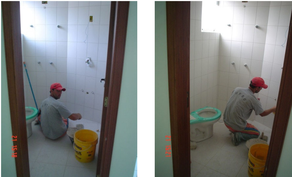
Figura 12 – Operário responsável pela execução do rejunte de piso e parede, foto tirada no dia 21/11 no bwc suíte coluna 2 (dados da pesquisa).
