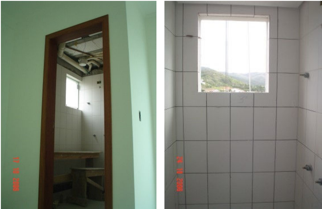
Figura 17 – Esquecimento de execução do forro do lado esquerdo e do rejunte no lado direito da figura (dados da pesquisa).
