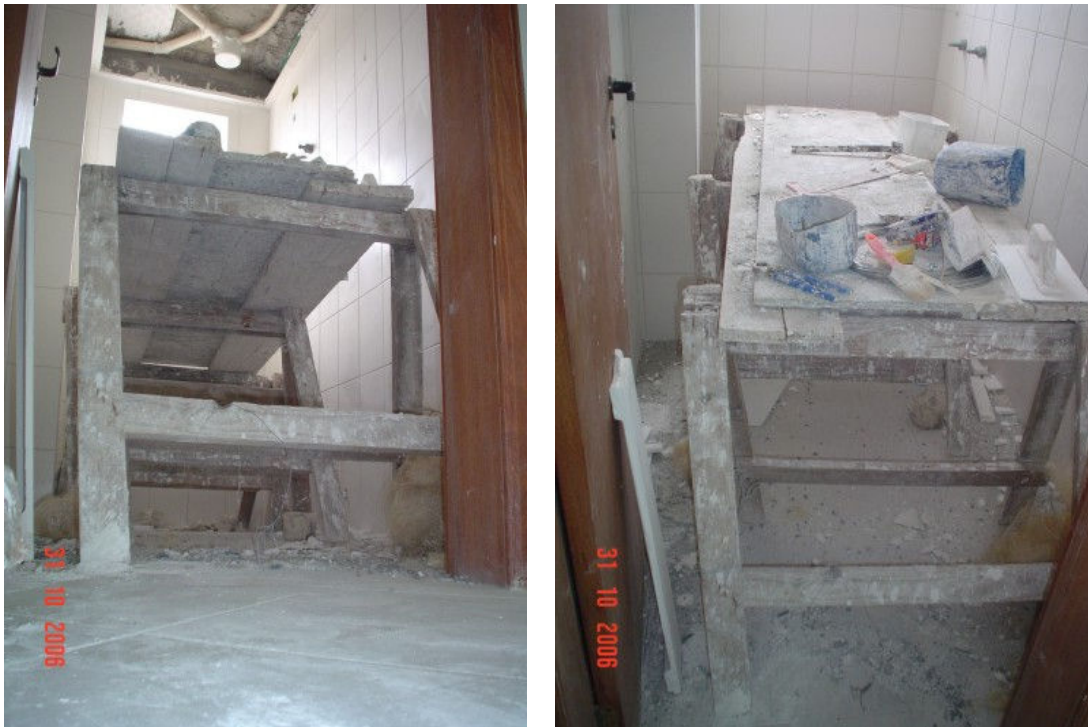
Figura 15 – Erro de execução, piso aplicado sem o forro de gesso e cavalete sobre piso sem proteção (dados da pesquisa).
