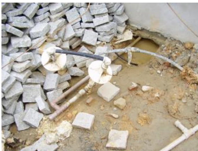
Figura 18: Cavalete solto e inclinado
