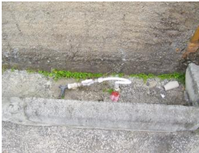
Figura 20: Cavalete com material inadequado
