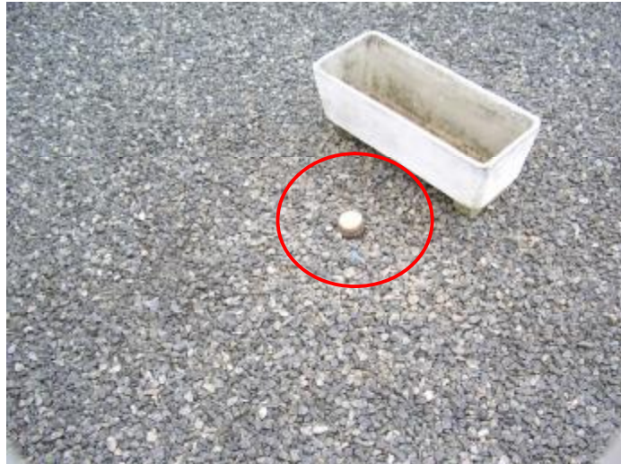
Figura 22: Cavalete e hidrômetro enterrados
