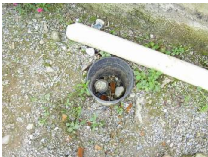
Figura 24: Cavalete inexistente e proteção do hidrômetro inadequada
