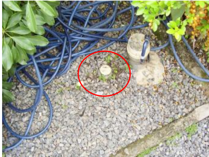
Figura 19: Cavalete e hidrômetro enterrados
