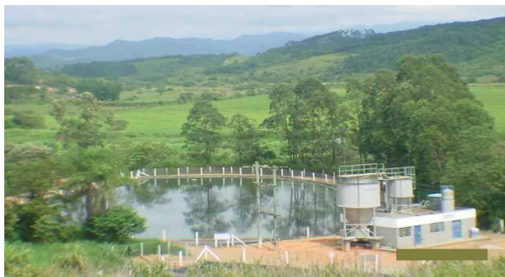
Figura 5.2: Estação de tratamento do lixiviado do aterro sanitário de Biguaçu.
