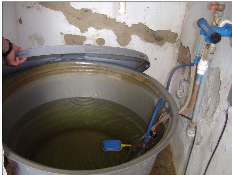
Figura 44: Tanque para armazenamento de hipoclorito de sódio – ETA de Coronel Vivida, para posterior mistura à água que será tratada. (Foto da autora 15/05/2005).
