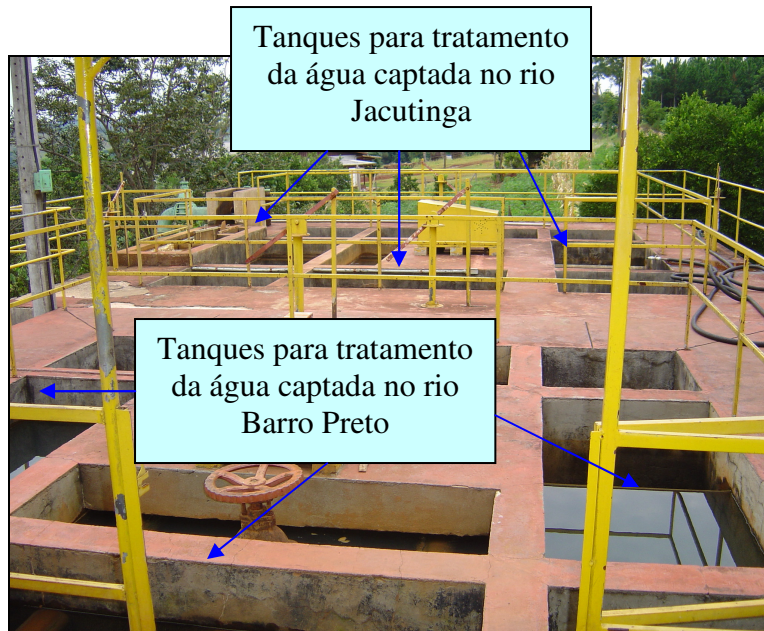
Figura 40: Tanques de tratamento de água na ETA de Coronel Vivida. Na parte superior da foto estão os tanques para floculação e filtração da água proveniente do rio Jacutinga, e na parte inferior, estão os tanques utilizados para a água do rio Barro Preto. (Foto da autora 15/05/2005).
