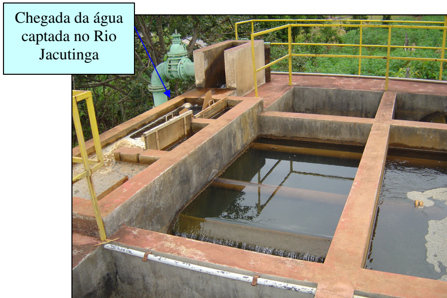
Figura 39: Chegada da água captada no rio Jacutinga e tanques onde se efetua o seu tratamento na ETA de Coronel Vivida. O local de chegada da água situa-se na parte superior esquerda da foto. Nas partes central e direita estão alguns tanques utilizados na floculação e filtração da água. (Foto da autora 15/05/2005).
