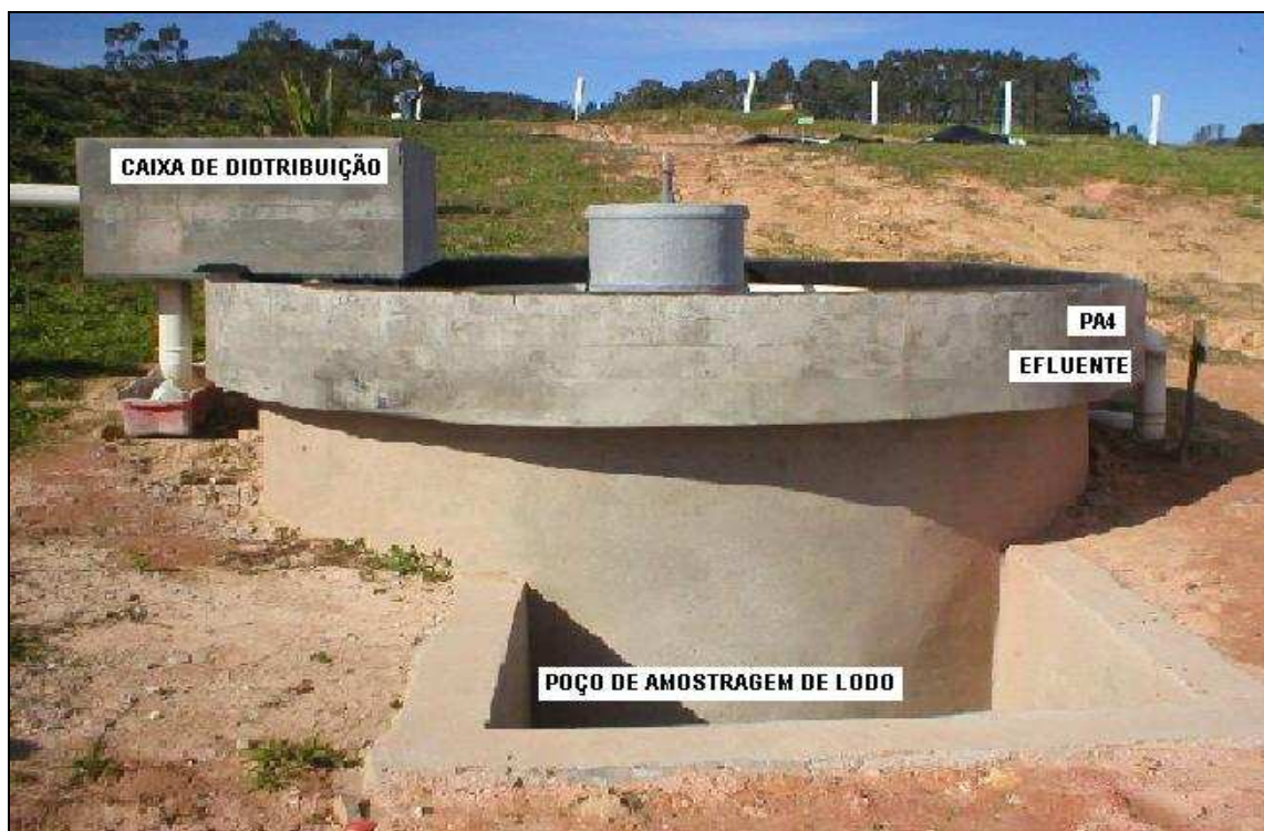
Figura 4.9 – Vista externa do reator UASB
