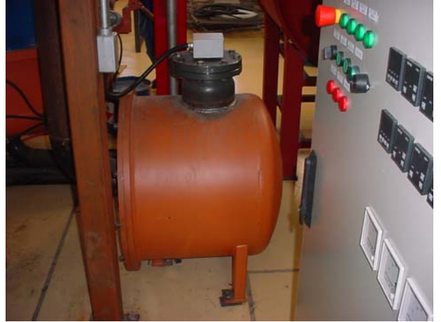
Figura 37. Ventilador para resfriamento forçado e painel de controle.
