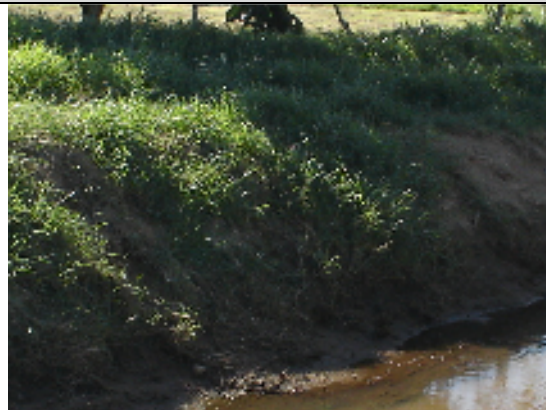
Foto 2 – Ponto de erosão da margem. Data: 14/03/2008.
