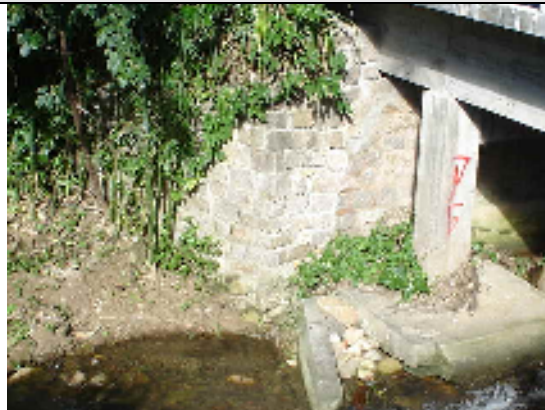
Foto 33 – Acumulo de resíduos sólidos e pedregulho ao redor do pilar da ponte na Rua Manoel Rosa dos Santos. Data: 26/03/2008.
