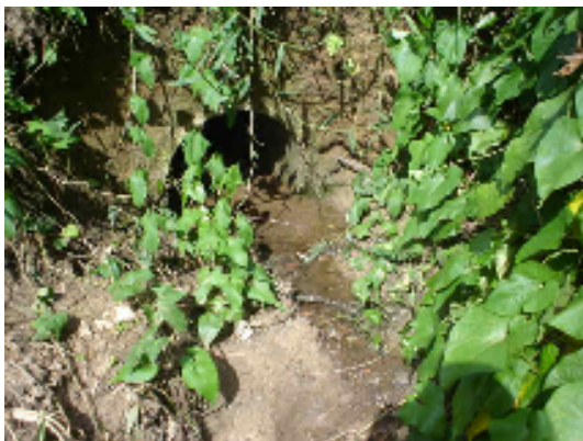
Foto 19 – Lançamento de efluentes e tubulação assoreada e obstruída. Data: 26/03/2008.
