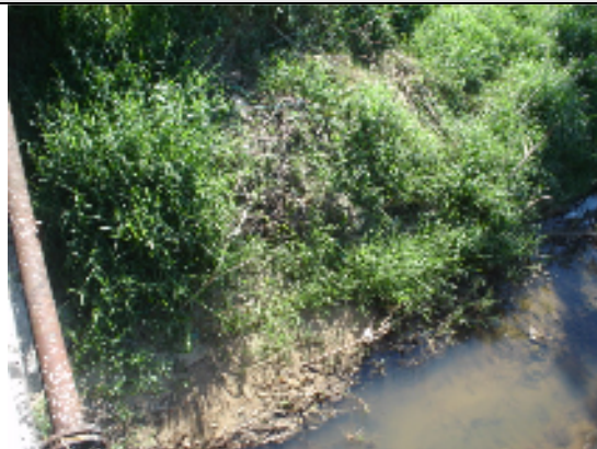
Foto 8 – Erosão da margem. Data: 14/03/2008.
