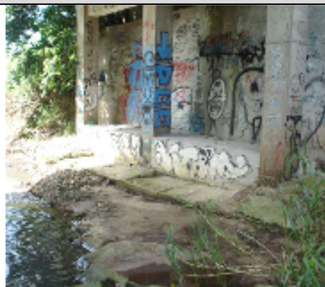
Foto 12 - Obstrução da seção transversal devido ao acúmulo de material fino e pedregulhos. Data: 14/03/2008.
