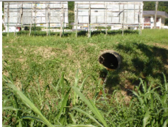
Foto 10 - Lançamento de efluentes ( água pluvial) – tubulação de drenagem. Data: 14/03/2008.
