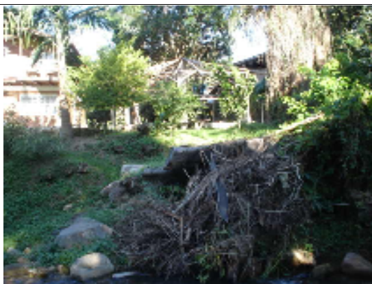
Foto 41 - Obstrução do escoamento devido ao acúmulo de material sólido (galhos e vegetação) na margem. Data: 26/03/2008.
