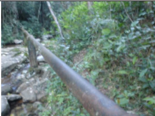
Foto 45 – Tubulação de captação de água da CASAN. Data: 26/03/2008.
