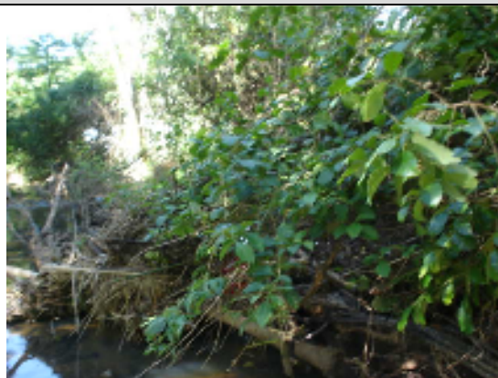
Foto 26 – Obstrução do escoamento por galhos e material sólido. Data: 26/03/2008.
