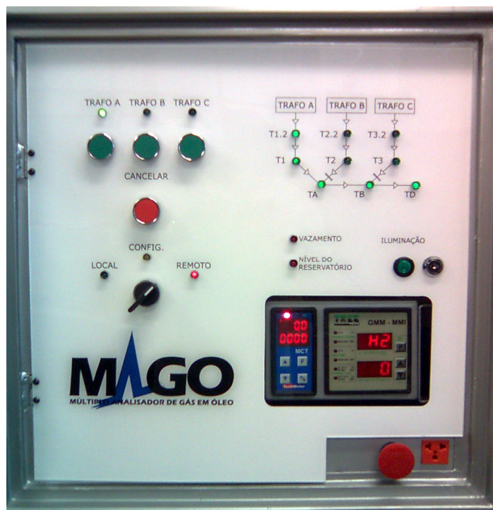
Figura 4.5 – Interface de comando local.
