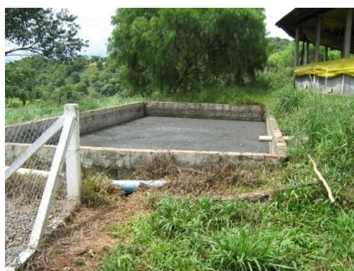
(b) Primeira lagoa de armazenamento
