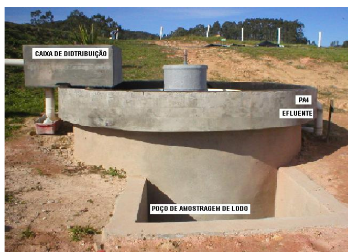
Figura 11 – Vista externa do reator.
