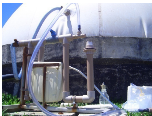
Figura 15 – Biodigestor, canalização do biogás e selo hídrico, da propriedade P1.
