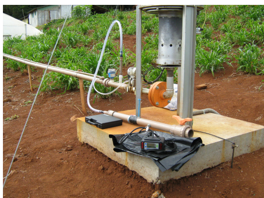
(b) Conexão entre o adaptador e a saída do biogás, numa das propriedades localizadas em Concórdia.
