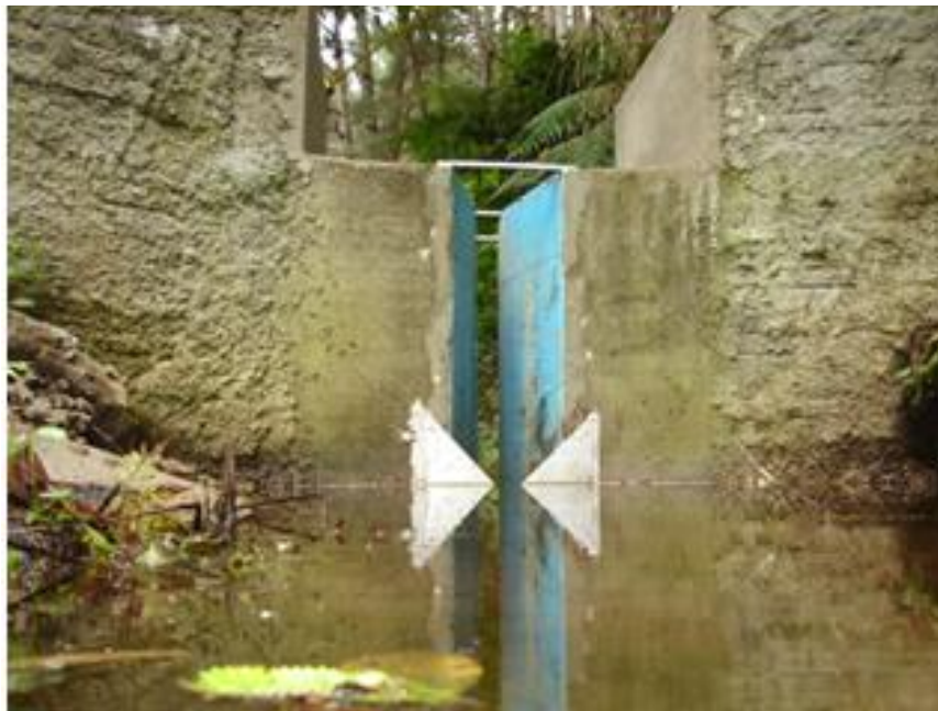
Figura 3.5 Calha Parshall com vertedor triangular na base instalada na bacia experimental.
