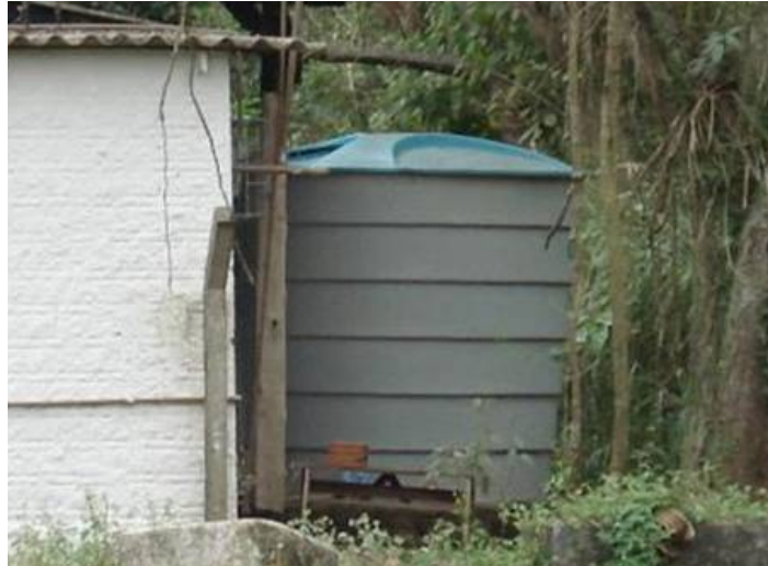
Figura 3: Reservatório de fibra de vidro utilizada para armazenamento do lixiviado bruto.
