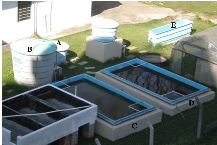
Figura 4: Sistema de tratamento biológico e polimento final para tratamento de lixiviado. A) tanque de equalização (efluente bruto); B, C e D) sistema de lagoas e E) filtro de pedras para polimento do efluente final.
