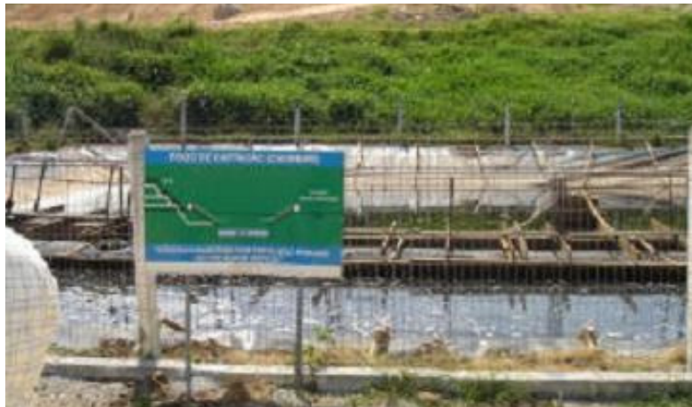
Figura 2: Poço de captação de lixiviado do aterro sanitário de Biguaçu. Fonte: ABES – SC, 2006.
