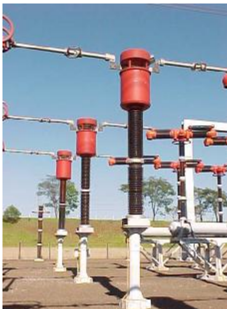
Figura 6 – Transformadores de corrente instalados em subestação
