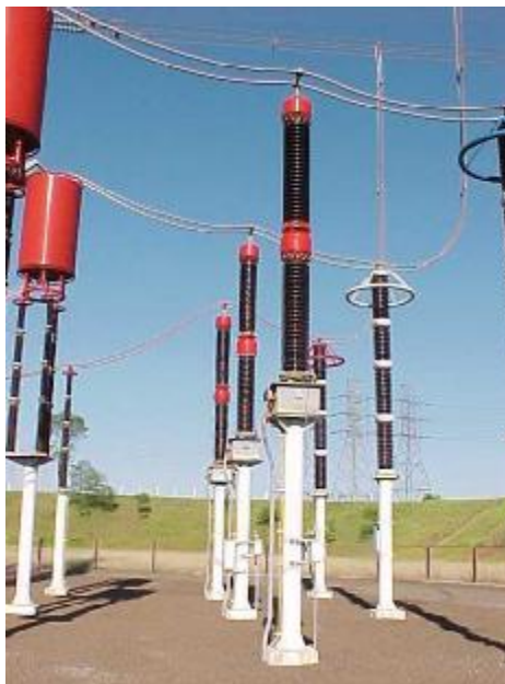
Figura 7 – Transformadores de potencial instalados em subestação
