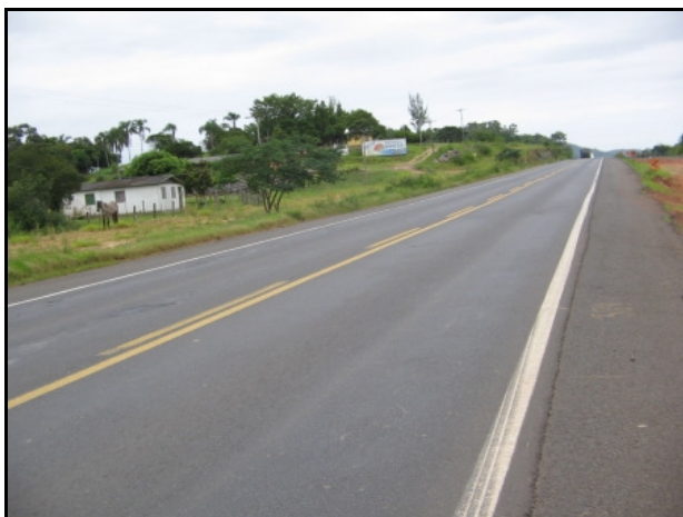
Figura 15 - Situação física do Trecho Sul (Km 285) em 2004. Fonte: ESGA (2008).
