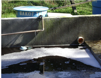
Figura 6 Vista parcial do reservatório de evaporação com detalhe à tubulação para eliminação de líquido em excesso
