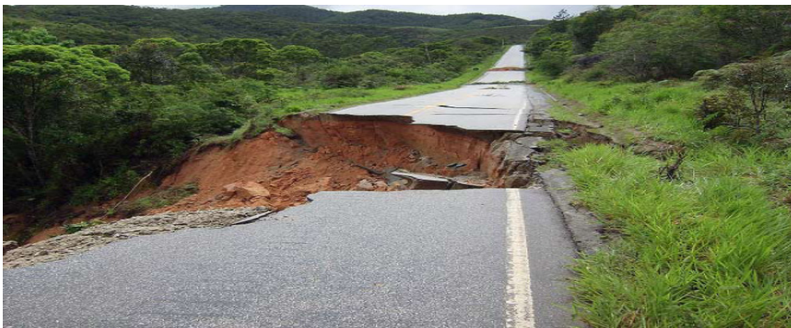
Figura 3 – Escorregamento na rodovia 116
