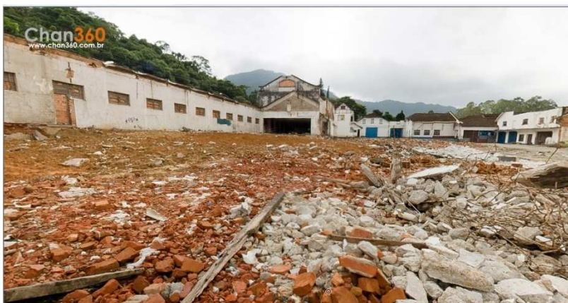
Figura 63: Imagem que demonstra a destruição desse importante exemplar do patrimônio industrial edificado, em 27/05/2010 Fonte: http://www.chanfotos.com/arquivos/78_out.swf
