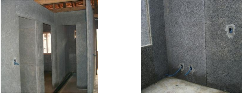
Figura 5.50 – a) Instalações elétricas de interruptor da sala e b) Instalações elétricas de interruptor e tomadas do quarto. Fonte: Construpex (2009)
