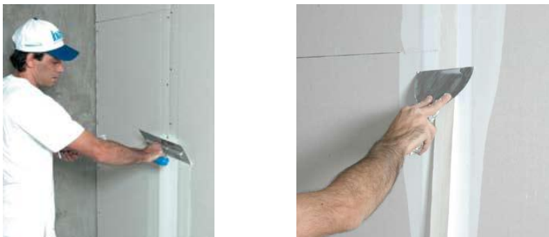
Figura 4.2 – a) aplicação da primeira camada de massa na junta e b) a fita é colocada na extensão da junta sobre a massa . Fonte: Placo (2009)
