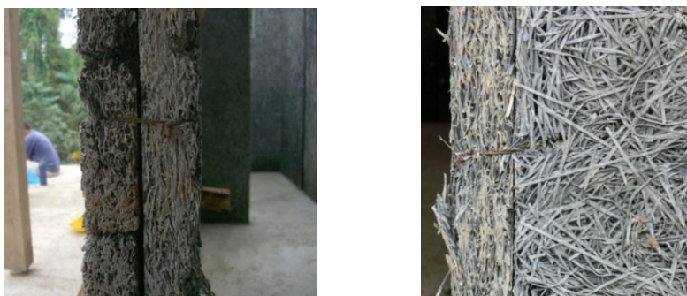
Figura 5.54 – a) Vista da união das duas placas e amarrações das placas em arame de aço galvanizado e b) Vista lateral da amarração em paredes em 90 graus. Fonte: Construpex (2009)
