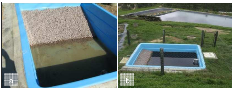
Figura 6 - a) Lagoa-filtro antes do enchimento; b) lagoa-filtro em operação
