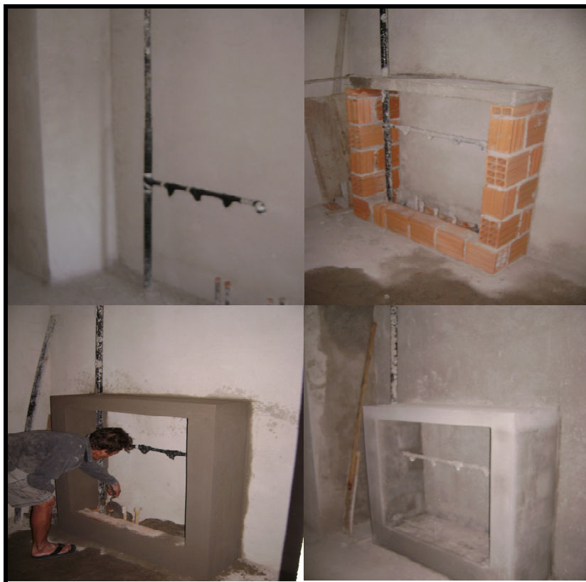
Figura 6.11 – Execução de quadro para medidores de gás e influência no reboco, na região do corredor de acesso aos apartamentos
