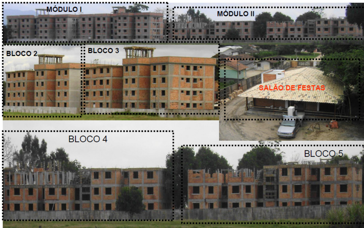
Figura 6.19 – Montagem de fotos com a situação da obra em 03 de junho de 2009 – E1
