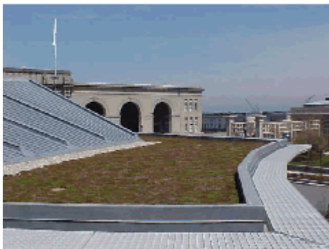
Figura 14 - Aplicação da ecotelha na cobertura de uma edificação.
