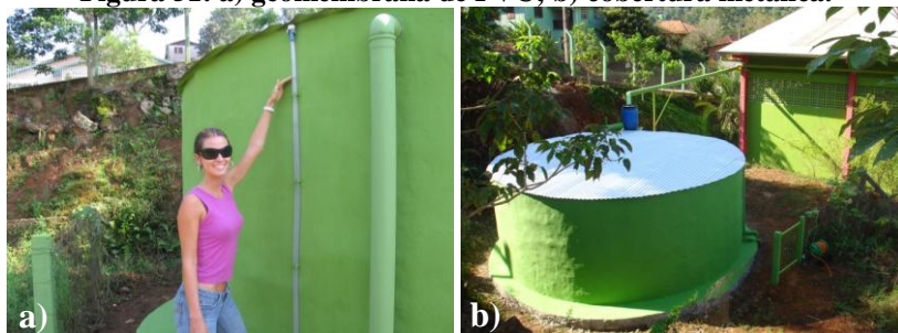
Figura 52: a) medidor de nível; b) vista geral do reservatório.
