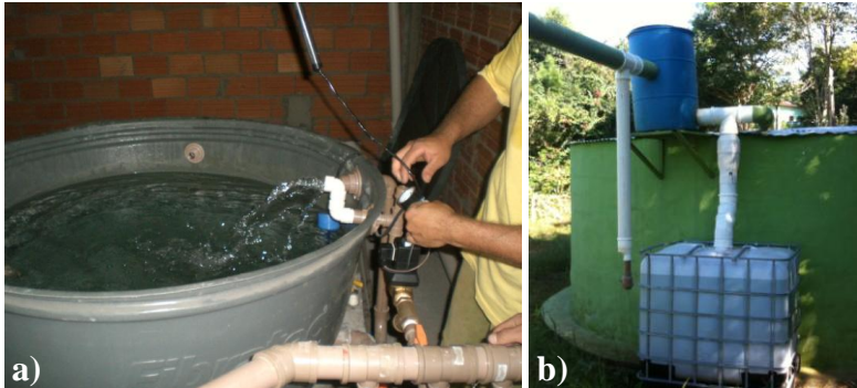
Figura 53: a) reservatório intermediário do Sistema piloto S1; b) dispositivo de descarte de sólidos e desvio dos primeiros escoamentos.
