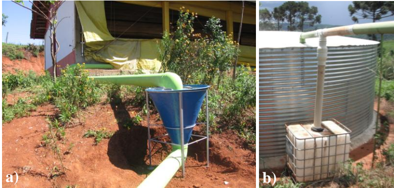
Figura 67: Dispositivos de descarte de sólidos (a) e desvio dos primeiros escoamentos (b) instalados no Sistema piloto S4.
