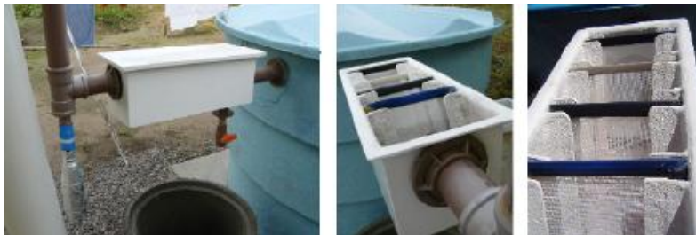
Figura 8: Sistema de peneiramento.
