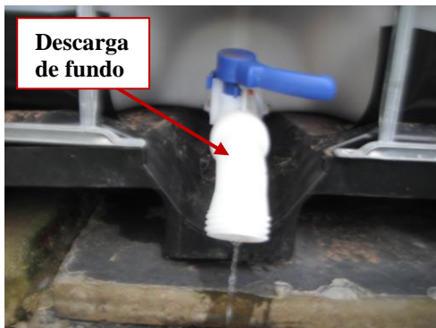
Figura 31: Descarga de fundo do dispositivo de desvio dos primeiros escoamentos.
