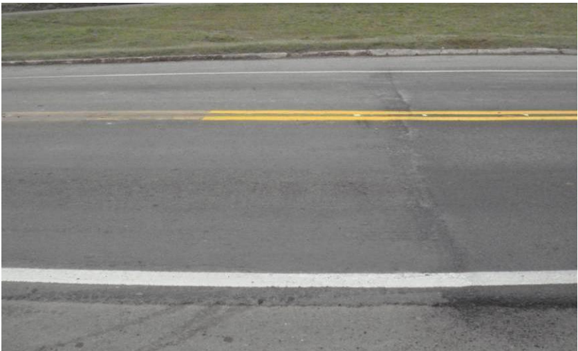
Figura 70 Trecho da BR116 com sinais de recuperação
