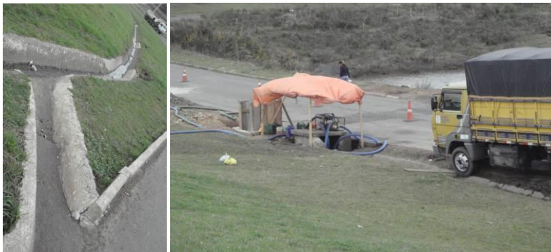
Figura 71 Dispositivos de drenagem/limpeza
