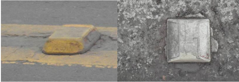
Figura 69 Sinalização horizontal sem conservação
