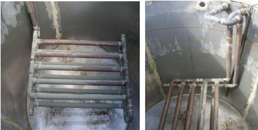
Figura 11: Detalhes do trocador de calor.
