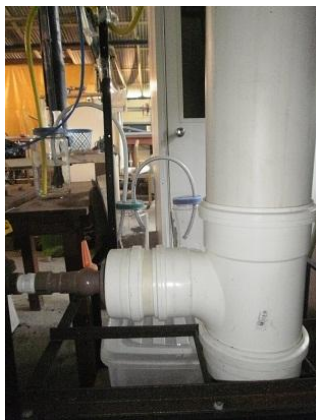
Figura 14 Fundo e entrada de ar lateral da torre de air stripping .
