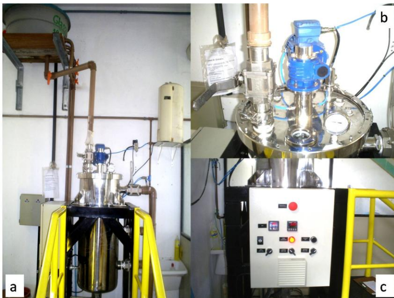
Figura 11 Sistema piloto para digestão de lodo (a); detalhe da região superior do digestor (b); painel de controle e comando do digestor (c).
